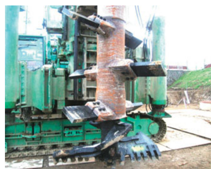
攪拌混合装置
